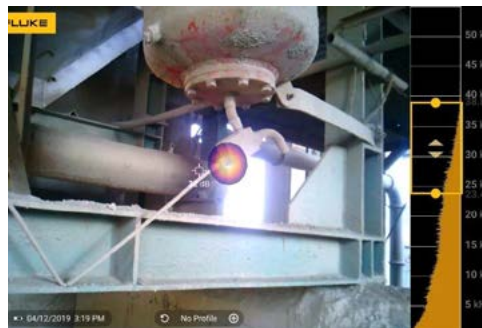
位置：磨煤机袋房主体 设备名称：布袋收尘室 磨煤机袋房发生漏气，降低系统真空，从而增加运营成本。
