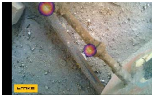
位置：压缩机房 设备名称：手动阀和活接头 手动阀和活接头发生空气泄漏
