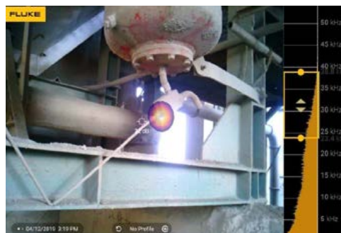
位置：空气炮 NRV 回转窑窑尾 设备名称：窑尾 空气炮 NRV 窑尾 ( 5 bar ) 发生压缩空气泄漏，从而增加运营成本
